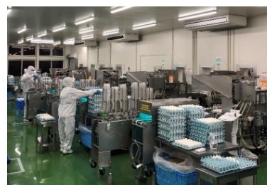
空調管理された作業所。
